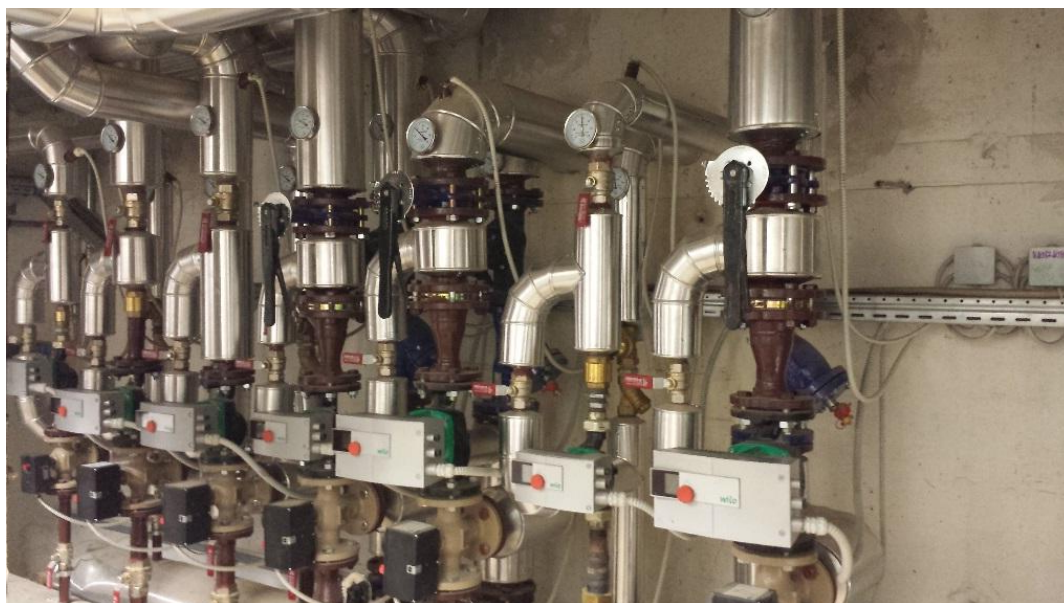
Slika 4: Kotel in strojne inštalacije kotlovnice na lesno biomaso.
